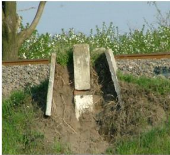
3-8. ábra Megrongált vízszintes alappont keresztmetszete vasúti töltés közelében
